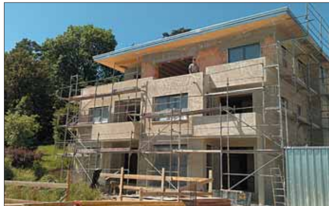
Rohbau der ersten Wohnungen der Wohnresidenz Wolfental mit freiem Blick nach Süden.
